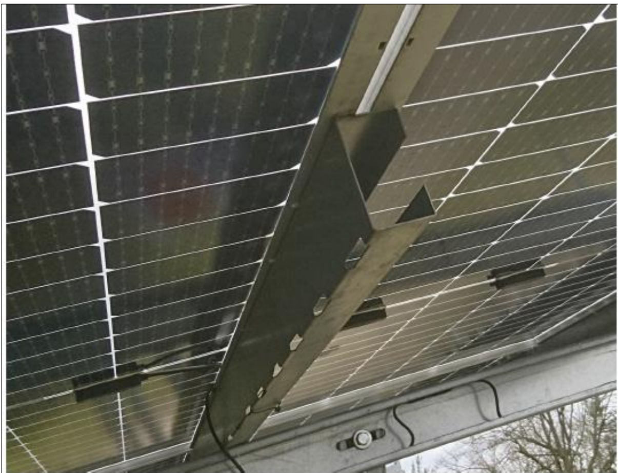
Abb. 2 Regenwasserverteilsystem unter den Modulen (Foto: SUNFARMING)
