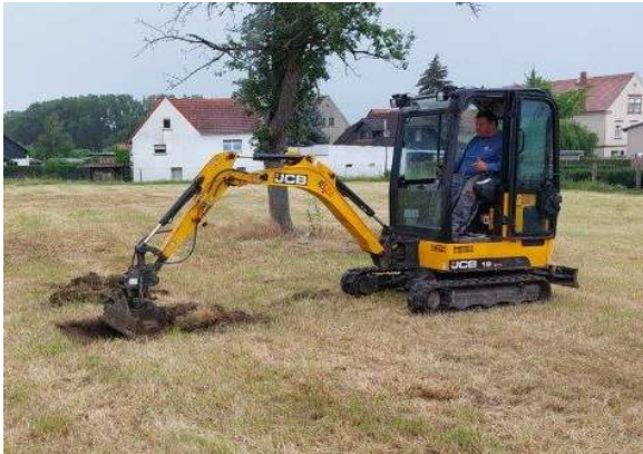
Abtragung der Oberbodenschicht mit Hilfe eines Baggers; Aushub des Handschurf per Hand
