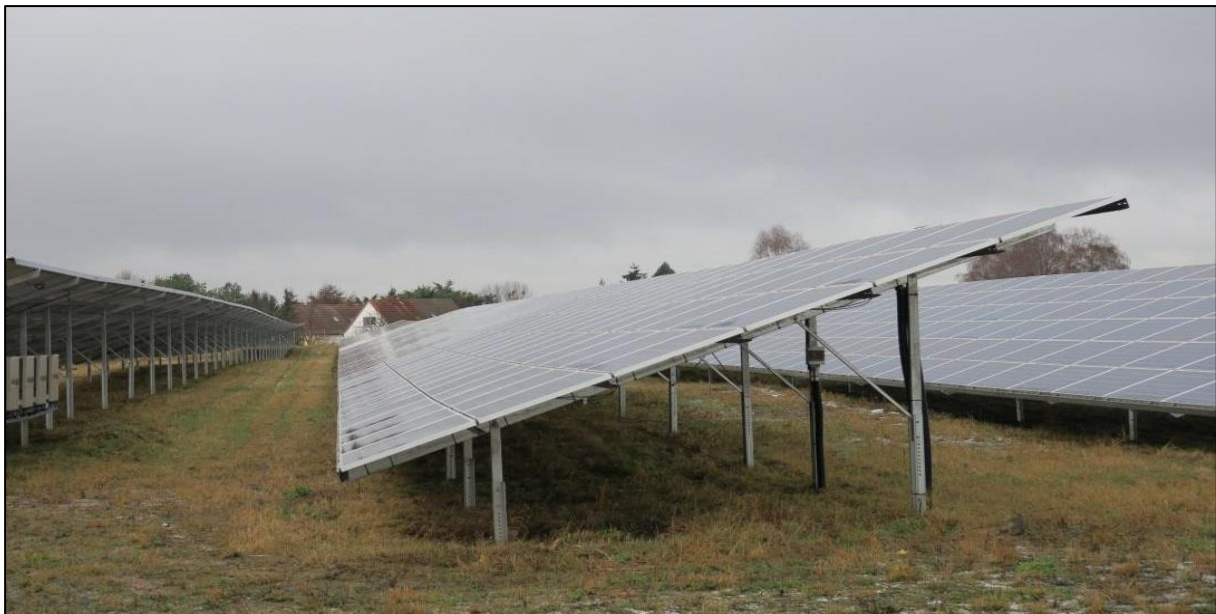
Abb. 3: Beispiel einer Freiflächen-PVA
