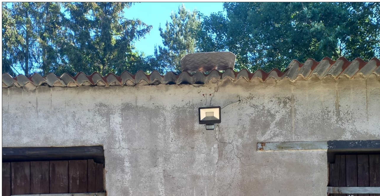
Abb. 4 Spalten im Gebäude (kein Besatz erkennbar)
