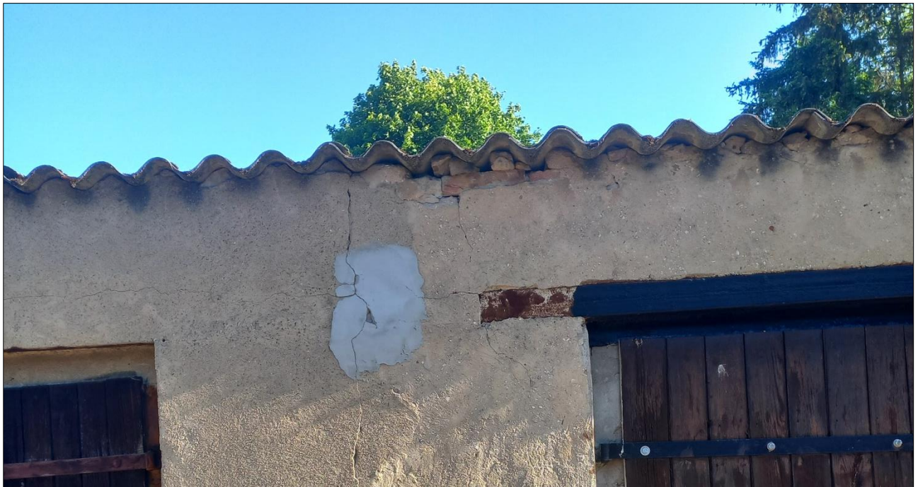
Abb. 3 Spalten in den Garagen (kein Besitz erkennbar)
