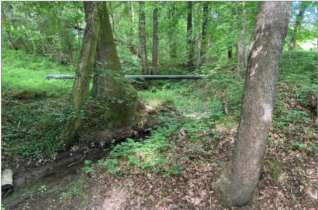
Abb. 3 Rohr über Hellerbach
