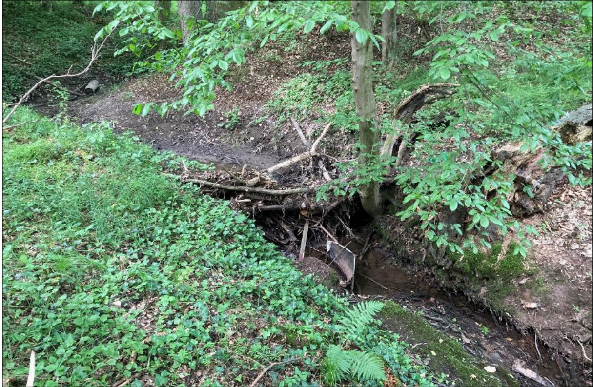
Abb. 4 Schuttablagerung im Hellerbach
