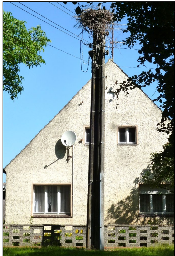
Abb. 35 Eintrag von Nistmaterial durch Weißstorch (Nr. 16) auf Mittelspannungsmast im Siedlungsbereich Münchhausen, bereits mit Abwehreleinrichtung ausgestattet
